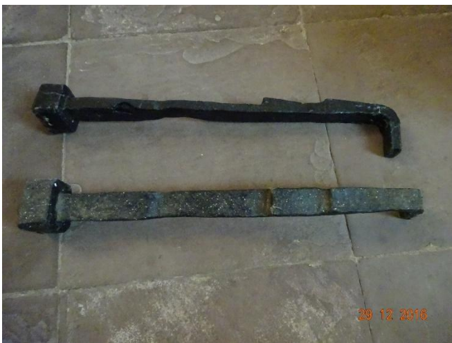
Een zware kantige balk boven de gewelven, droeg door middel van twee zware ijzers het anker, dat stijf tegen het gewelfrozet was getrokken.
